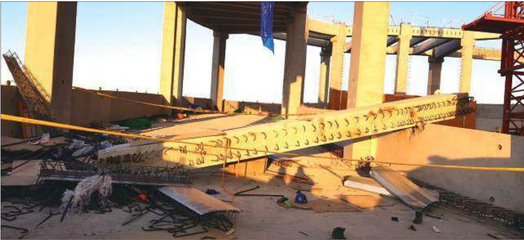
12월 20일 산재 추락사로 세 명이 목숨을 잃은 평택 물류창고 신축공사 현장. 공사판은 죽음이 도처에 널린 지뢰밭이나 다름없다
